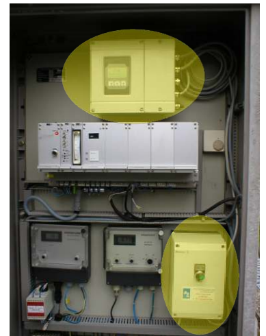
Messumformer und ZUB-POT/EMV Box im vorhandenen Schaltschrank integriert.
