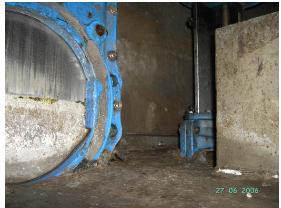
Einbetonierte Schwimmer-Drossel und Handschieber erschweren die Demontage.
