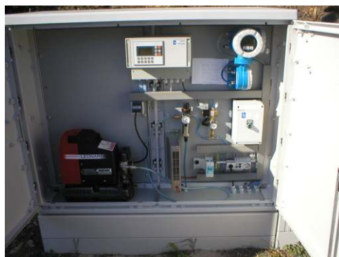
Freifeldschaltschrank mit Platzreserve
