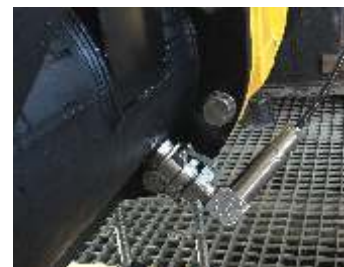
Druck-Höhenstandsonde misst bei geschlossener Alligatorklappe/Anaconda-Ventil den Höhenstand im Becken vor der Drossel.
