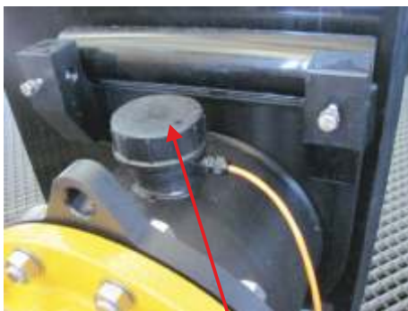
Der Fettdetektor ist am obersten und damit am kritischsten Punkt installiert.
