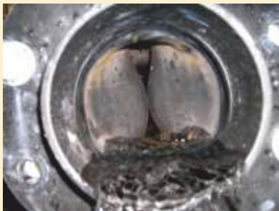
Anaconda-Ventil (DN 100-250) fast geschlossen. Es bleibt bis zum Schluss oben und unten offen, damit Luft und Geschiebe durchgelassen werden.
