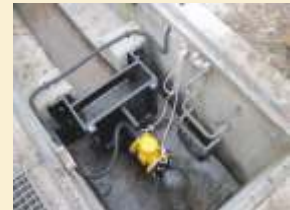
Q 3 -BiK SK Auslauf Kläranlage
