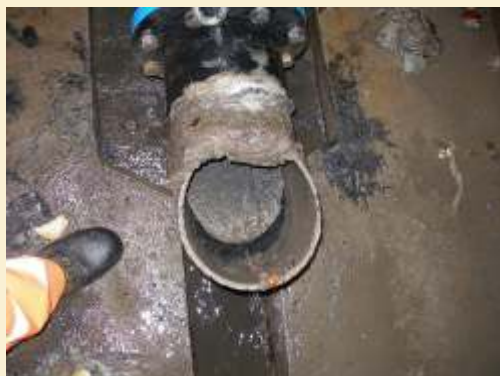
Typische Ablagerung durch Sand. Der Durchfluss- Messfehler ist kleiner 2%
