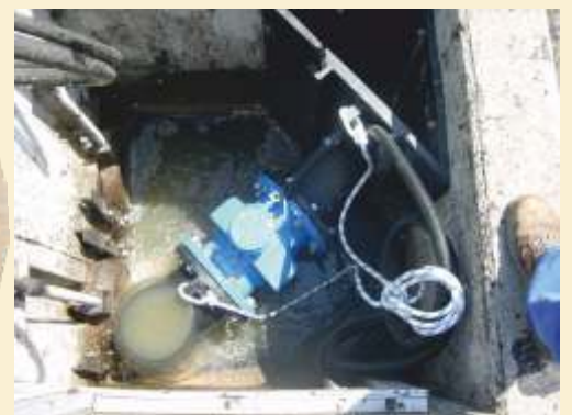
Kläranlagenzulauf extrem eng
