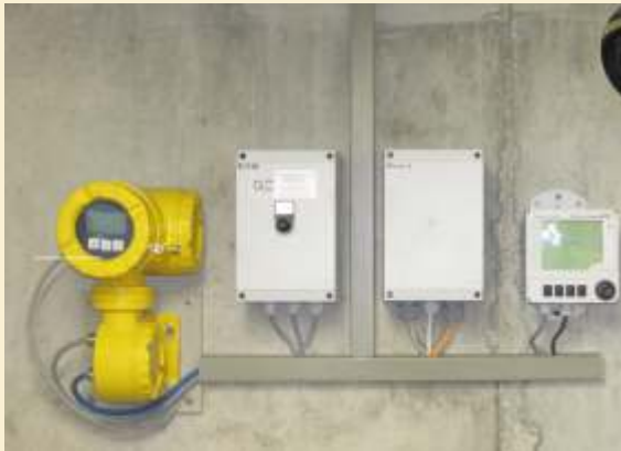
MID Messumformer und Potbox direkt an die Wand. Mit pH Messung
