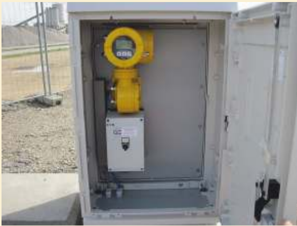
Einfacher Schrank für eine Durchflussmessstelle
