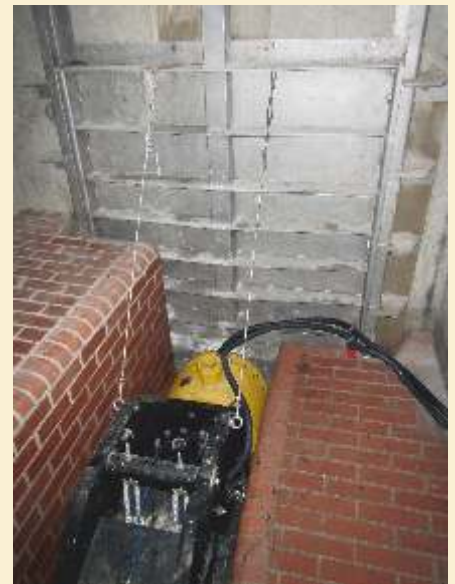
Alligator DN 350 (VA) ohne Einlaufstrecke in einem Plattenschieber
