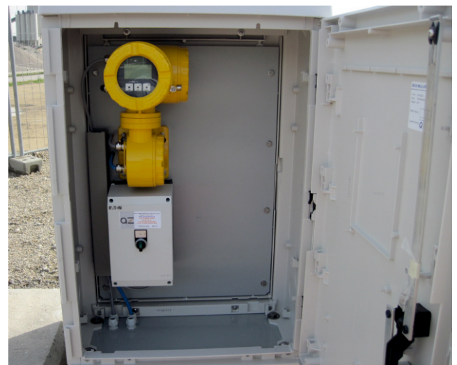
Bild: Schaltschrank mit Messumformer und PotBox
